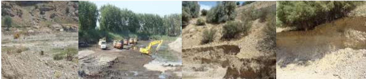
شکل ۴- تخریب بستر و دیواره‌ی رودخانه‌ی بشار
